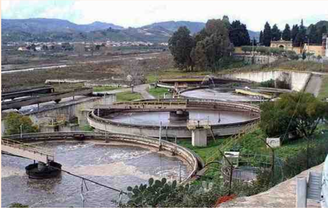
Depuratore di Cuma (NA) con gravi problemi di malfunzionamento, 2012 (da: http://www.lettera43.it/cronaca/napoli-estate-al-veleno_4367557827.htm )
