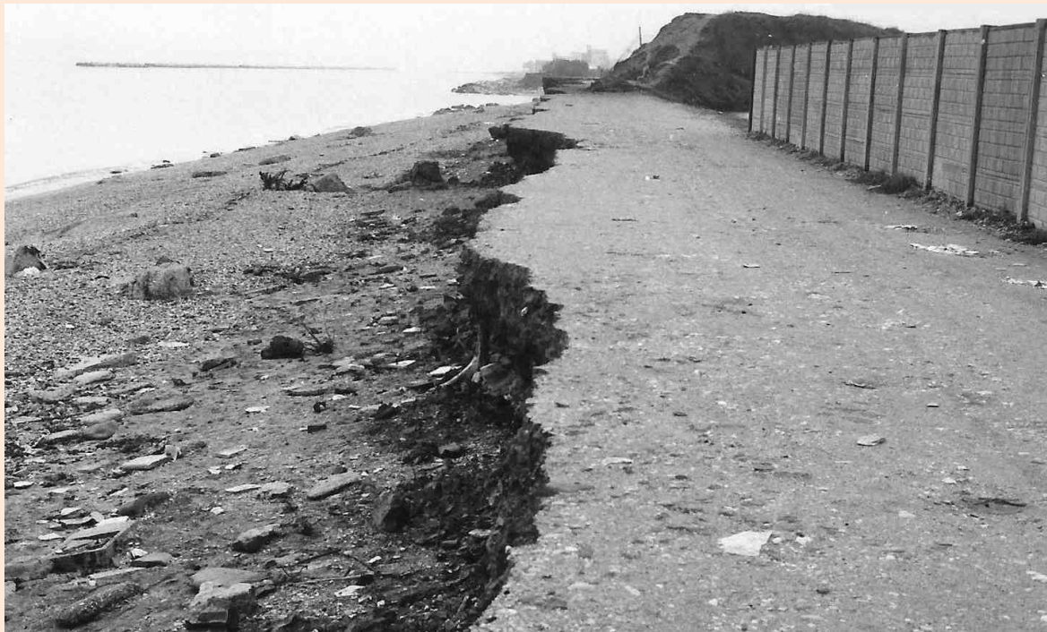
Strada parzialmente distrutta da una mareggiata a Fano (PU), 1975
