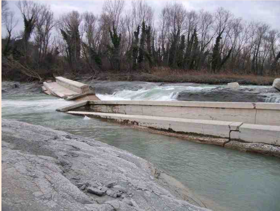
Traversa scalzata dall'erosione, basso F. Metauro (PU), 2011 (foto Simone Bai)
