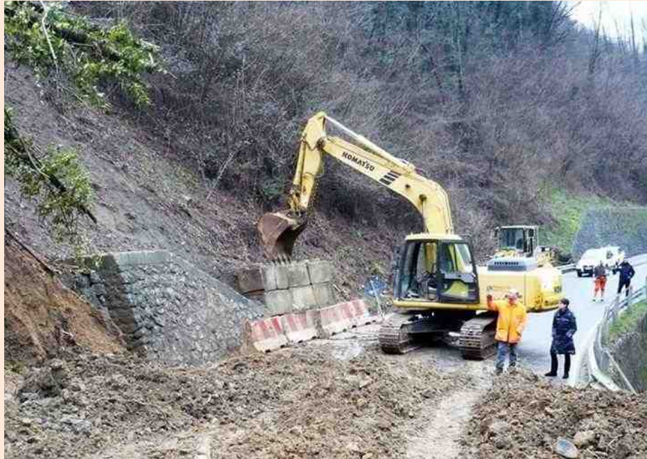
Frana che ha interrotto una strada (da: http://www.luccacitta.net/notizie/attualita/4586 )
