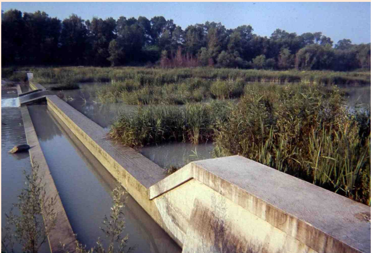
Traversa lungo il basso F. Metauro (PU), 1986 (poi distrutta da una piena)
